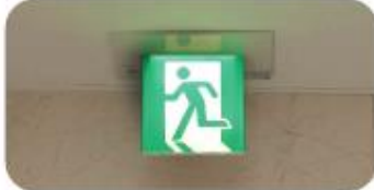
避難口誘導灯(避難口がわかる)
